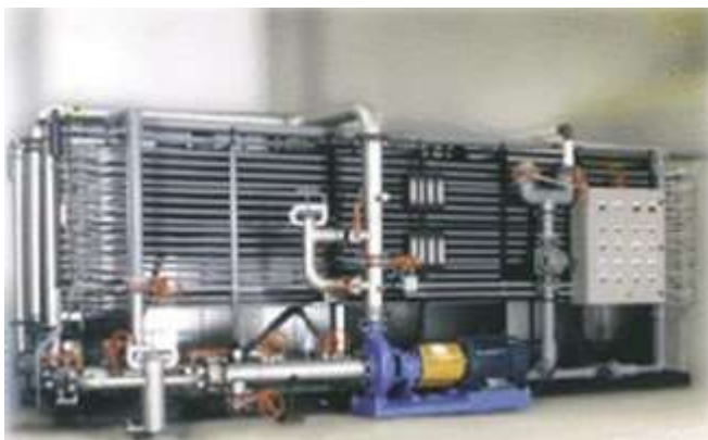
Dessalement eau de mer par osmose inverse
