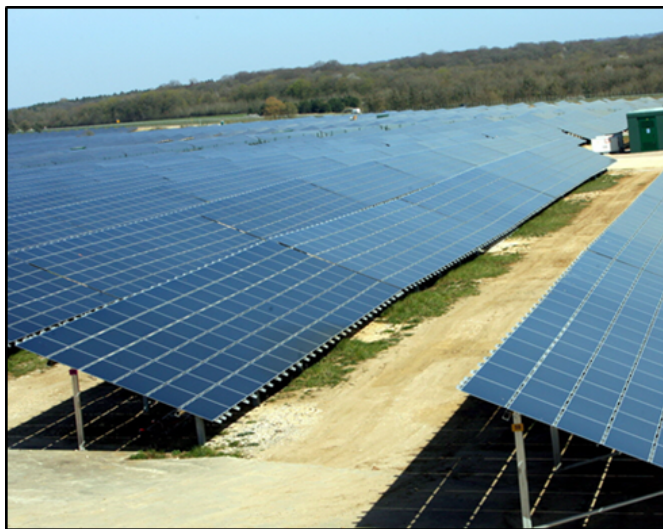
Centrale photovoltaïque de Toul-Rosières (France)
