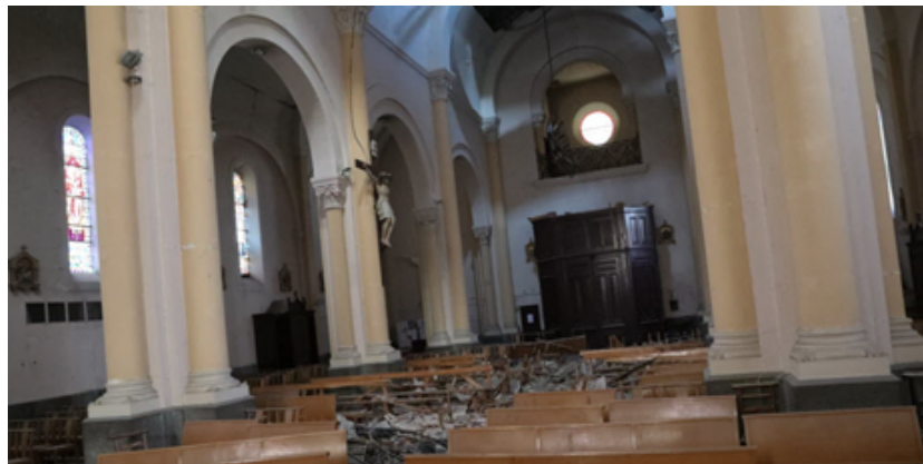
Vue intérieure de l'église du Teil qui, quatre ans après le tremblement de terre s'apprête à disparaître du paysage local.
