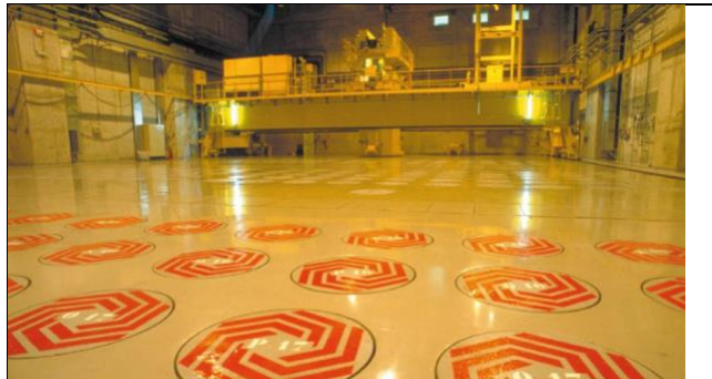
Figure 7 : Hall d'entreposage des colis CSD-V
