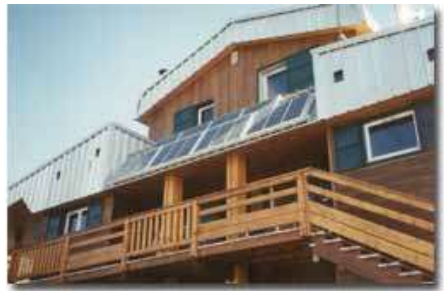
Installation autonome Refuge de Bésines (Hautes Pyrénées)
