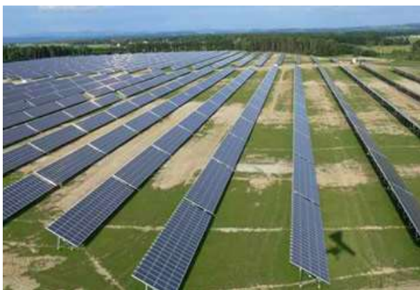
Centrale de puissance Pocking (Allemagne) 62000 modules
