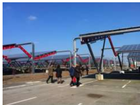
Figure 3 : Centrale photovoltaïque de Bordeaux-lac
